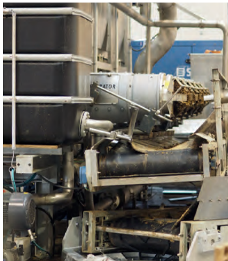
Sechs leistungsstarke FAN-Separatoren sorgen für bis zu 160 m 3 Durchsatz.
